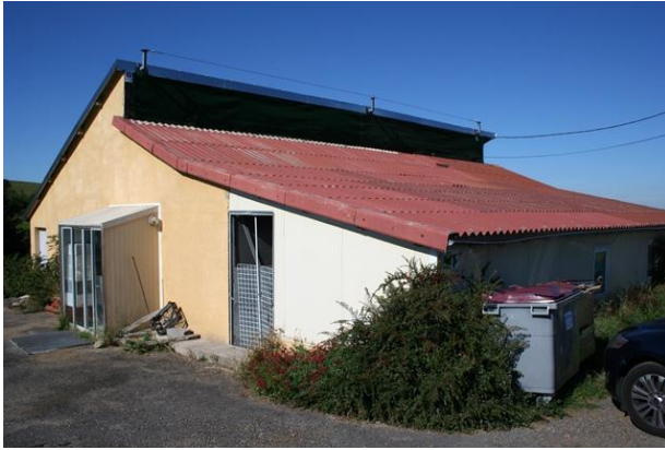
1. kép A húszem - a tető túloldala teljes egészében napelemekkel borított
